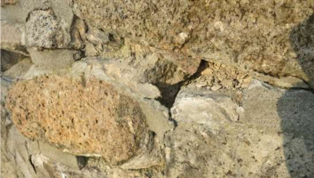
Figur 4. Løse fuger med allerede mye materialbortfall.
