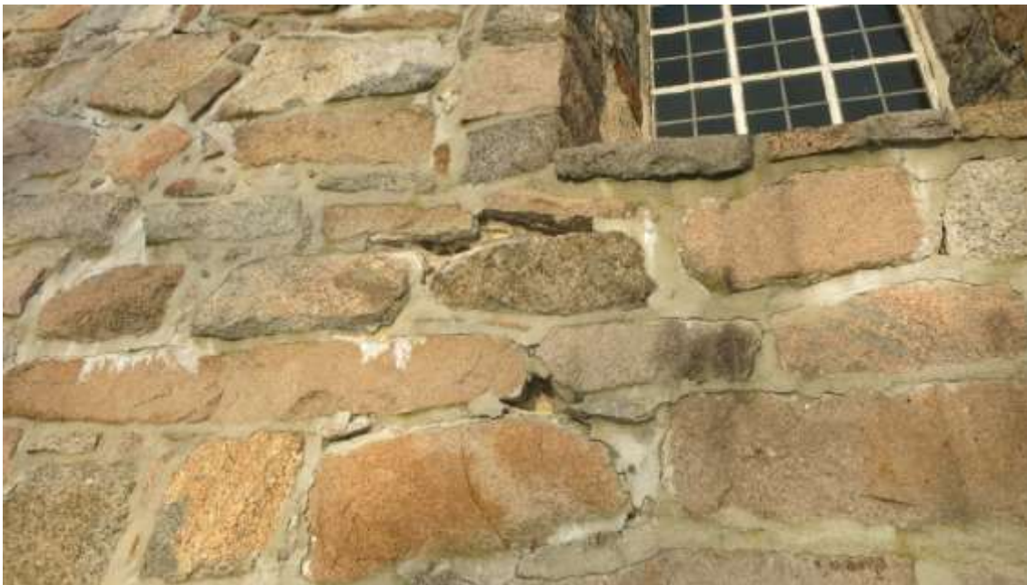
Figur 3. Materialbortfall i yttersjiktet. Pulverisert kalkmørtel innefor den diffusjonstette sementspekkingen.
