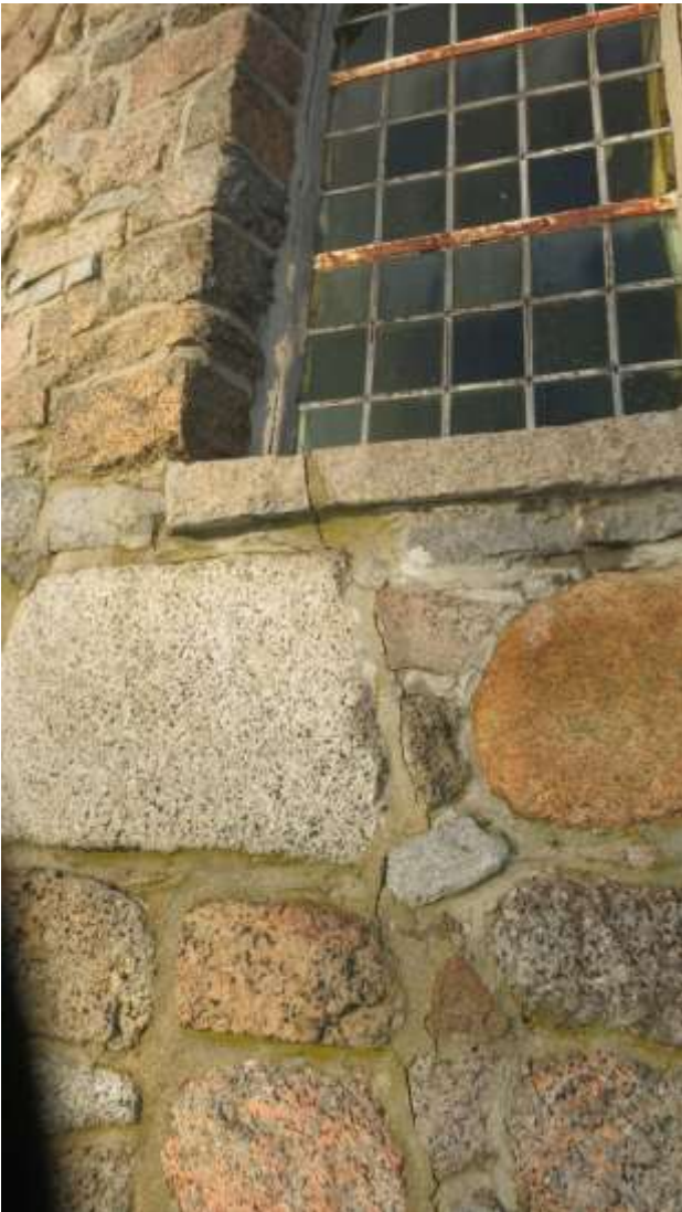
Figur 5. Gjennomgående sprekk i fuger og stein i sålbenk. Trolig har steinen allerede vært skadet da sementen ble påført i 1961.
