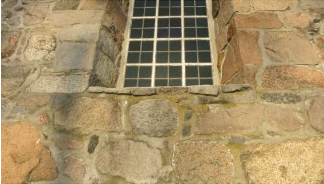
Figur 6. Tydelig algevekst under vinduene er tegn på bakenforliggende konstant fuktighet.
