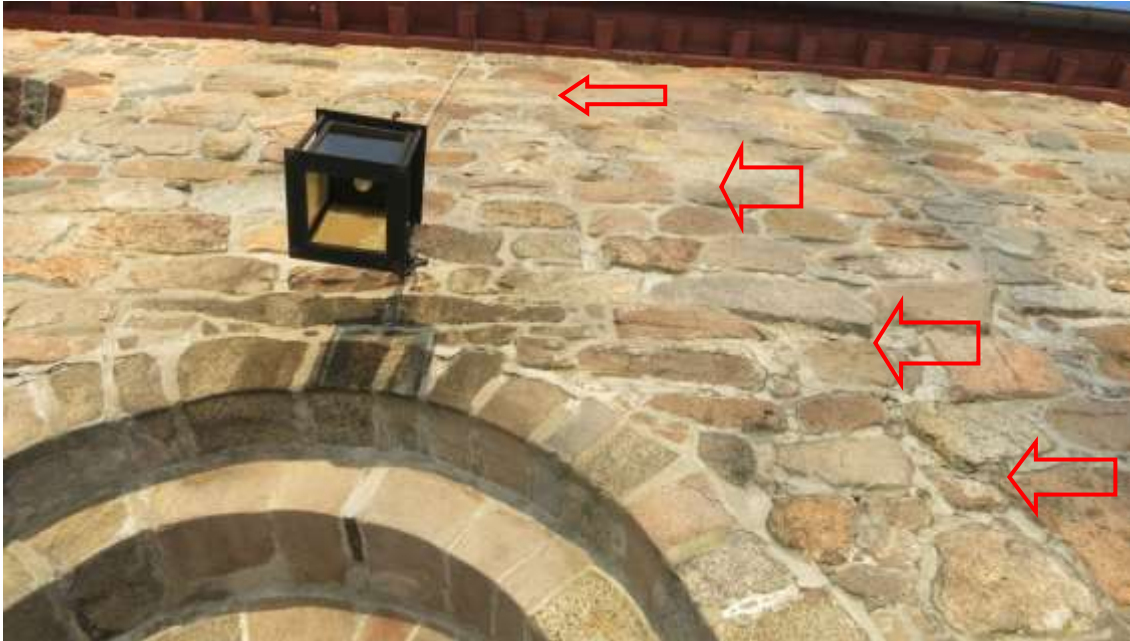
Figur 2. Mye diagonale sprekker i fuger ved sydportal.
