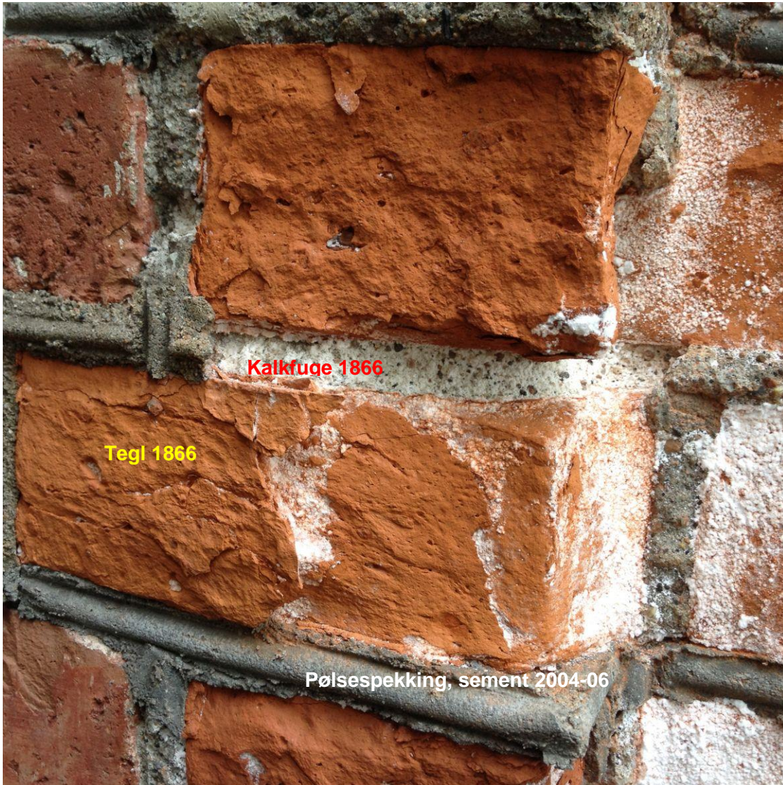
Figur 2. Opprinnelig tegl fuget med opprinnelig kalkmørtel, spekket med moderne sementmørtel. Skader: Avskallet brannhud på tegl, forvitring av kalkfuger, bortfall av sementholdige pølsespekkinger, skjolder fra saltufelling. (Foto: Mur og Mer, mai 2015)
