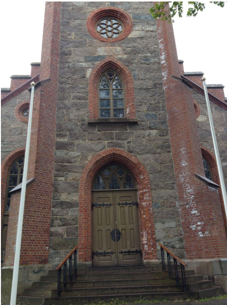
Vestfronten av tårnet, Tjøme kirke. Saltutfelling i teglmur på søndre halvdel av veggen. (Foto: Mur og Mer, mai 2015).
