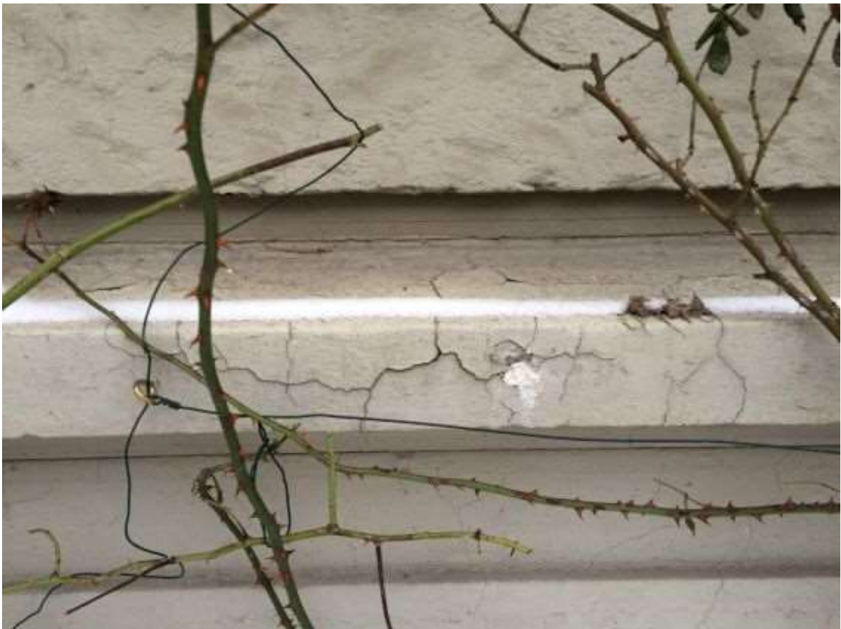
Figur 8. Horisontale og vertikale riss og sprekker på trukket bånd i etasjeskiller, sydvegg. (Foto: Mur og Mer, januar 2016)
