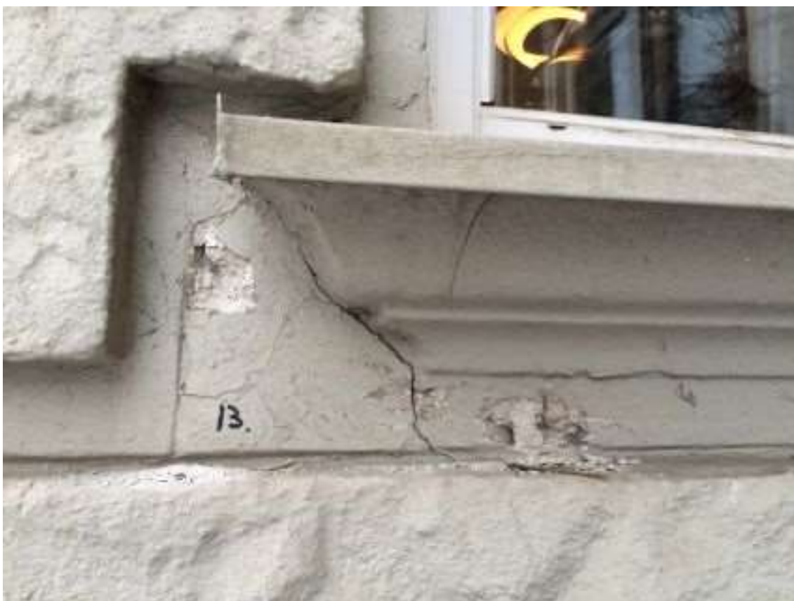
Figur 10. Sprekker i forbindelse med sålbenk under vindu på sydvegg. Kan skyldes sviktende forankring av treningen som gir sprekker under trykkbelastning. (Foto: Mur og Mer, januar 2016)
