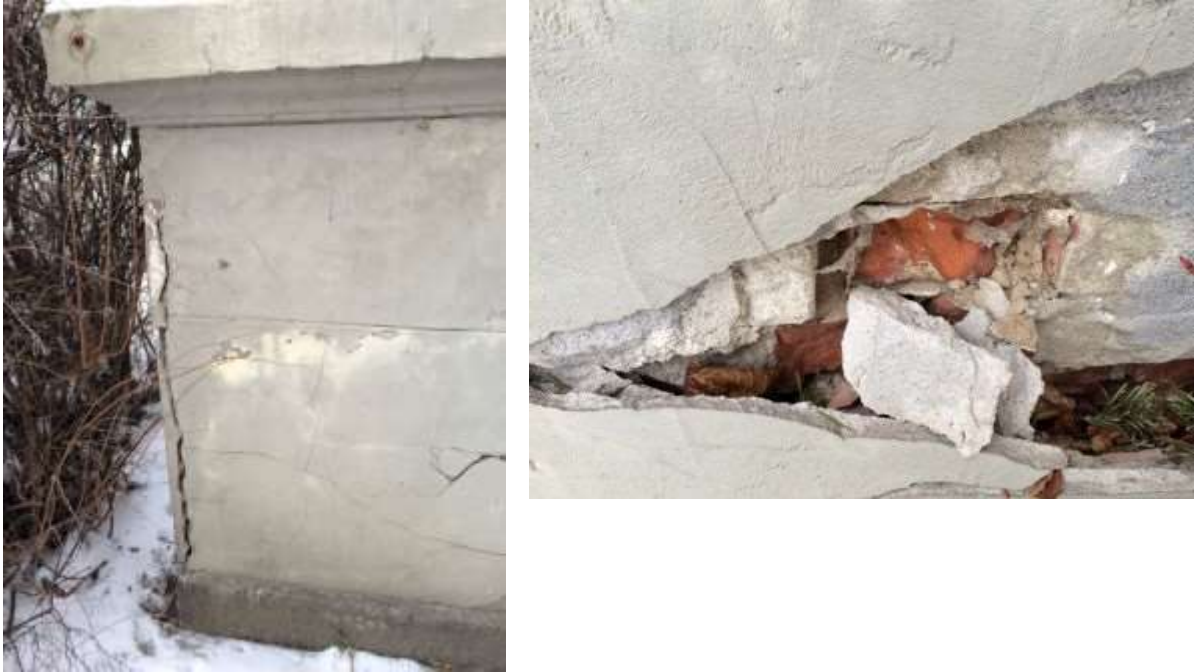
Figur 7. Skader på sokkel. Fasaden mot Magnus Bergs gate. Det er mye fuktighet i området på grunn av fuktoppsug fra bakken og dårlig avrenning i forbindelse med defekte takrenner. Når vannet blir liggende og ekspanderer ved frost bak diffusjonstett maling og bindingssterke sementreparasjoner vil porøs tegl og puss brytes i stykker. Til høyre har sementpuss trukket med seg teglens overflate. (Foto: Mur og Mer, januar 2016)
