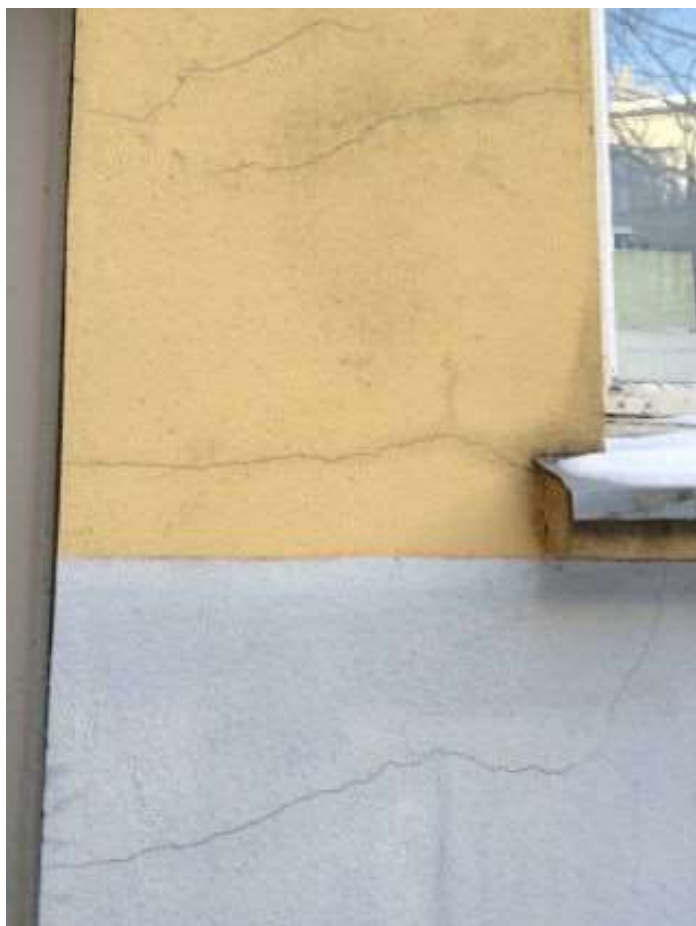
Figur 11. Sprekker generelt på hele bakgårdsfasaden. (Foto: Mur og Mer, januar 2016)
