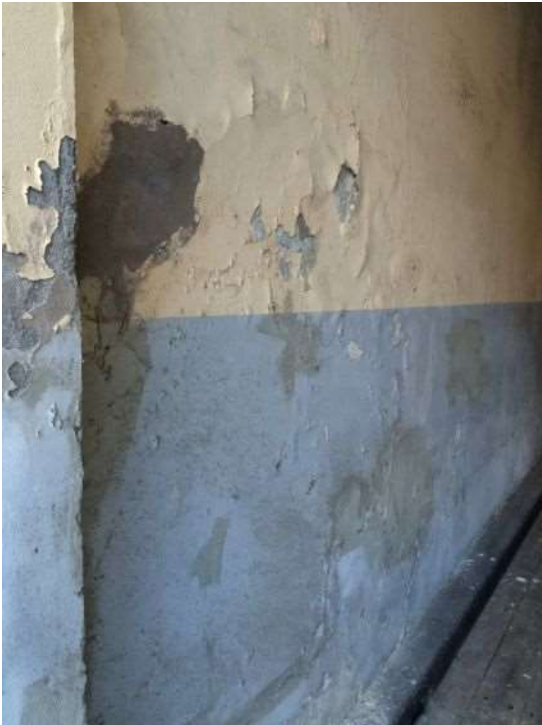
Figur 12. Mye sementreparasjoner er satt opp i flere perioder. Saltutfelling, bom og materialbortfall som resultat av mye fuktighet i kombinasjon med diffusjonstette og bindingssterke materialer. (Foto: Mur og Mer, januar 2016).
