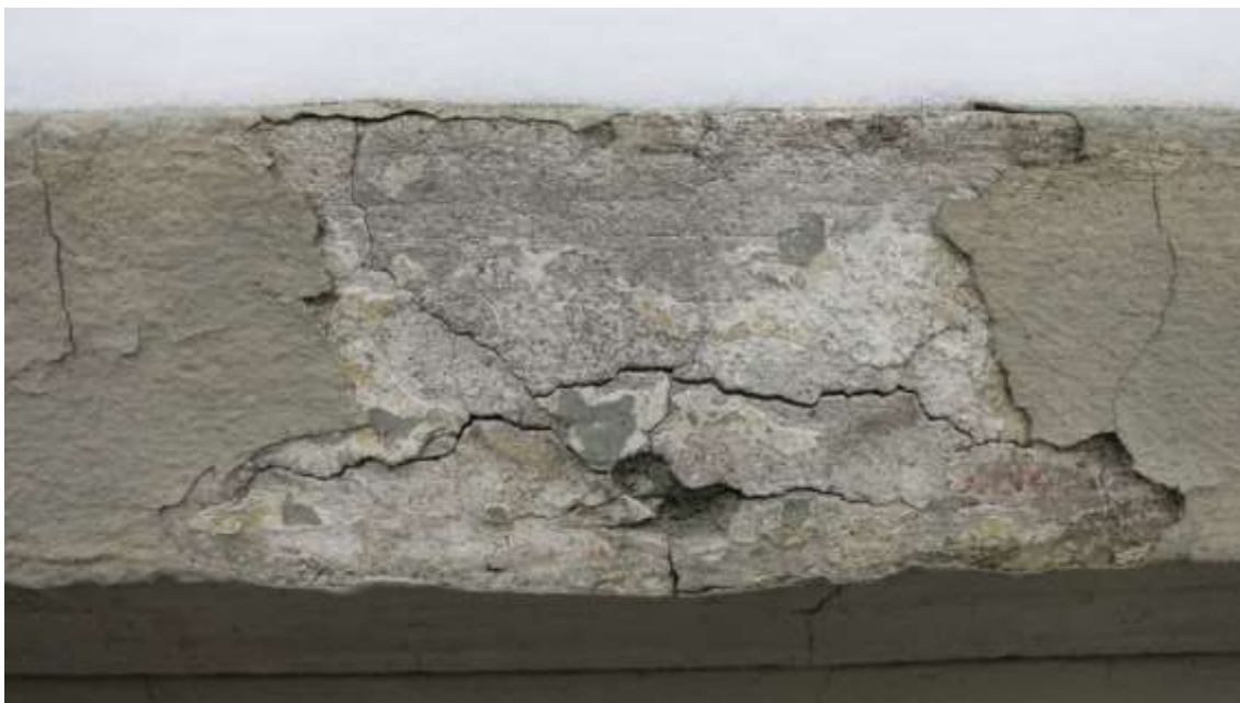
Figur 9. Mye ødelagt puss under den oppsprukne malingsoverflaten i trekning mellom sokkel og kvaderpuss. Sydvegg. (Foto: Mur og Mer, januar 2016)
